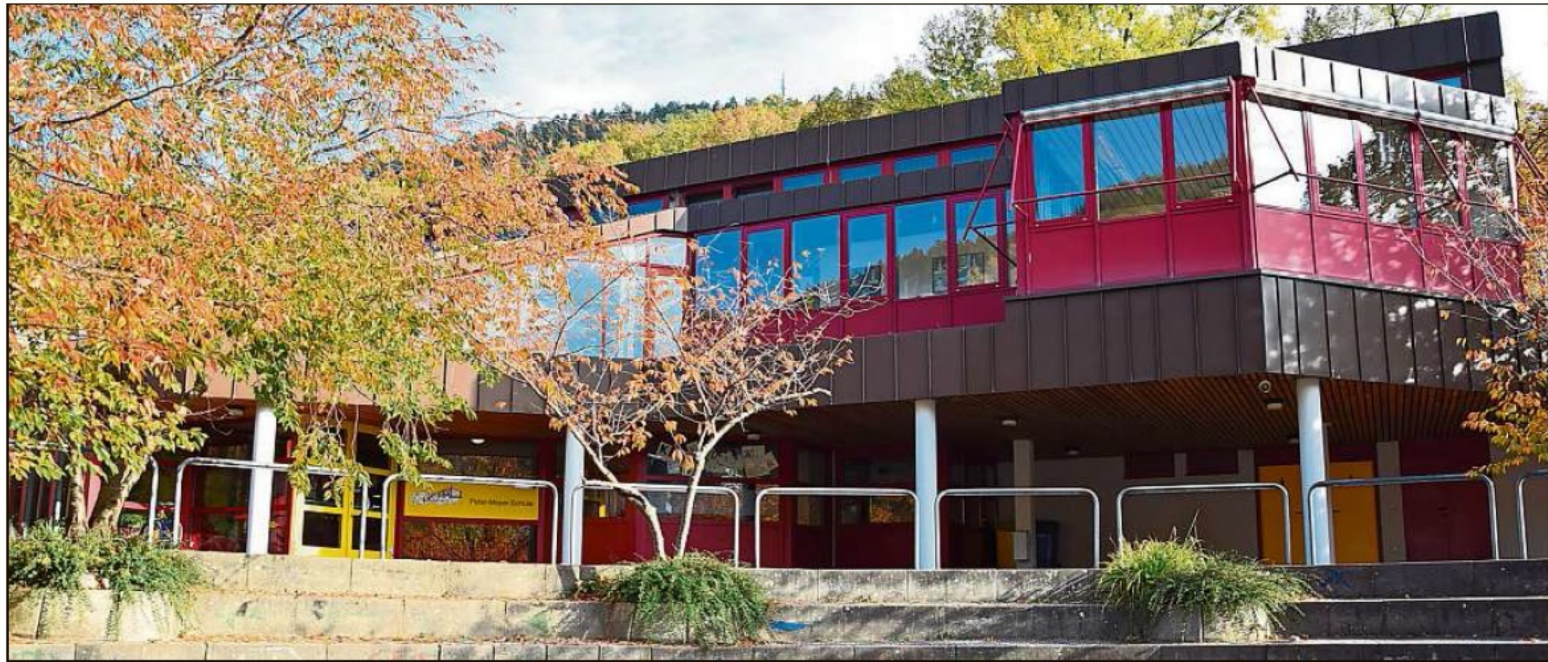
Die Peter-Meyer-Schule soll abgerissen werden. An dieser Stelle soll der erste Schulteil des Campusneubaus entstehen. Foto: Sum
